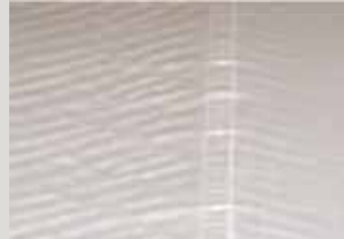
Ondulazioni vicine alle unioni Undulations near the seams
